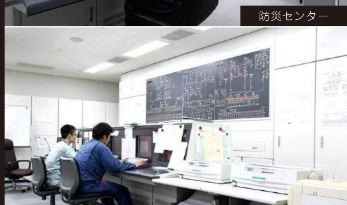
中央監視盤室
