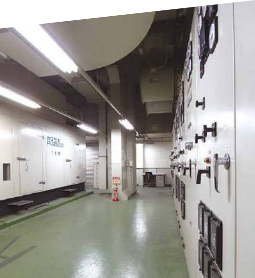
発電機設備 (B3F)
